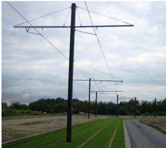
Figure 22 : Exemple poteau axial avec 2 consoles couvrant chacune 1 voie tramway (Tramway de Valenciennes)
